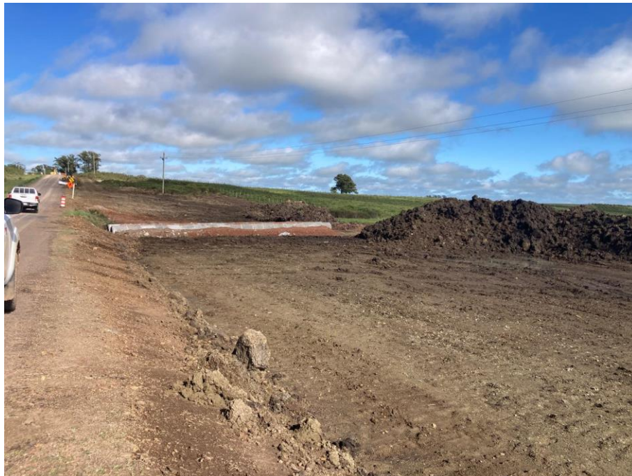
Imagen N°17: Alargue de alcantarilla tipo "Z".
