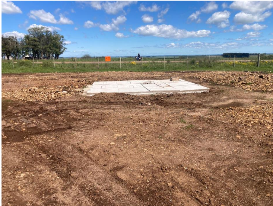
Imagen N°3: Pozo Impermeable para efluentes cloacales.
