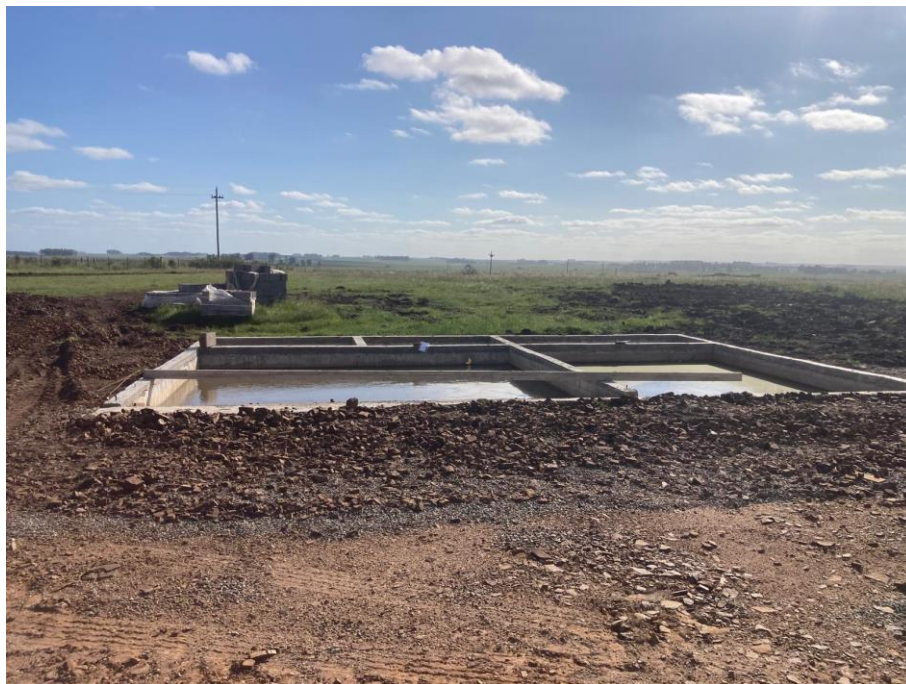
Imagen N°9: Piletas de lavado de mixers y herramientas con hormigón (izquierda) y piletas de efluentes de máquinas y camiones (derecha).
