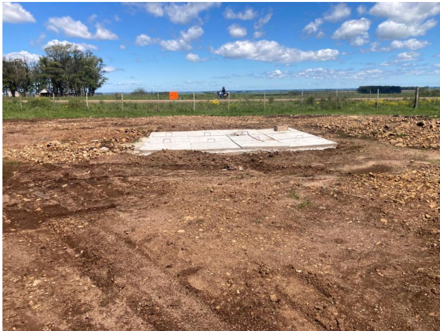
Imagen N°3: Pozo Impermeable para efluentes cloacales.
