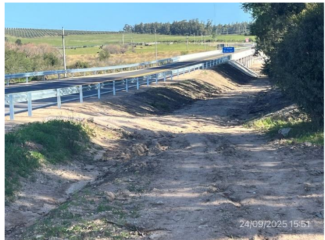
Foto 12.1-4, P04. Campamento provisorio desmontado. Falta reconfigurar cuneta en la senda a (-).
