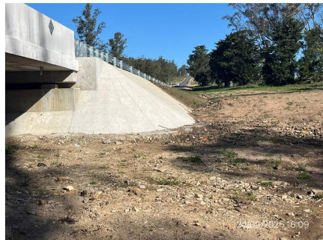
Foto 12.1-10, P05. Está pendiente de ser reconstruida la cuneta de la senda a (+). Permanecen algunos ROCs pendientes de disposición final.
