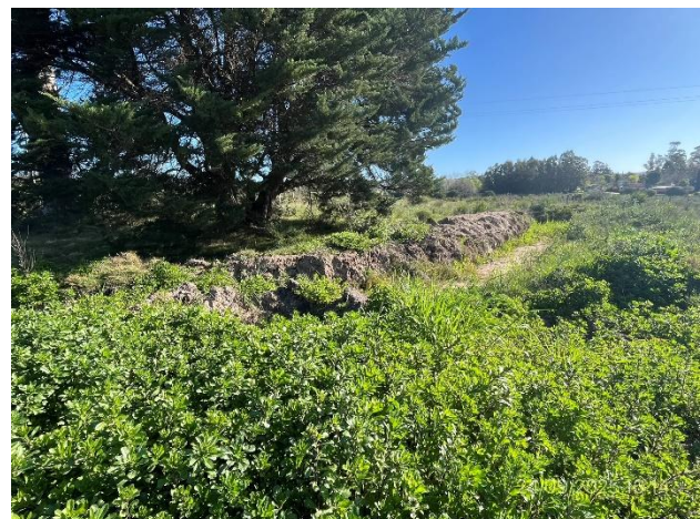
Foto 12.1-12, P05. Zanja de desagüe hacia terreno privado pendiente de ser reconfirmada.
