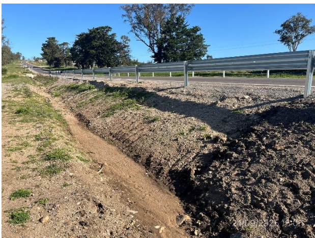
Foto 12.1-11, P05. Los taludes del acceso al puente tienen señales de erosión atribuible a escorrentía pluvial.
