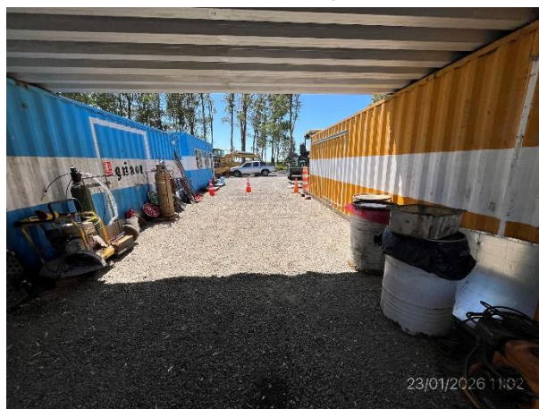
Foto 12.2-10, P03. Obrador. Está presente la infraestructura para acopio temporal de residuos segregados en origen.
