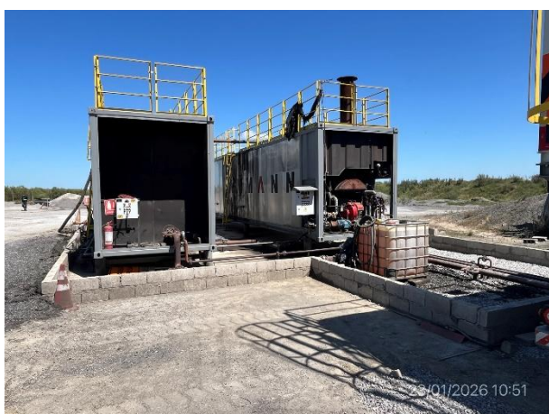
Foto 12.2-5, P03. Planta asfáltica, el envallado perimetral tiene perforaciones que disminuyen su capacidad.
