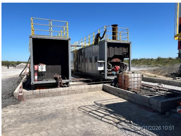
Foto 12.1-3, P07. Planta asfáltica, el envallado perimetral tiene perforaciones que disminuyen su capacidad.
