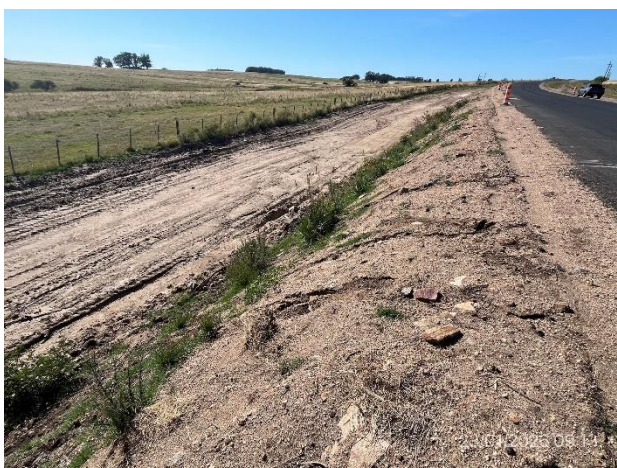
Foto 12.2-24, P04. Taludes en acceso con erosiones atribuibles a escorrentía pluvial por carencia de cobertura vegetal.
