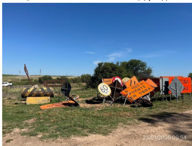
Foto 12.2-12, P02. Obrador abandonado de SACEEM, aún permanecen señales provisionarias por retirar.
