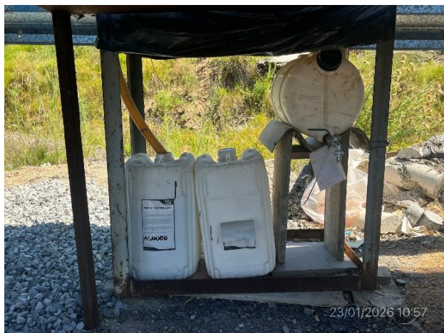
Foto 12.1-7, P07. Laboratorio de asfalto. El percloroetileno usado se almacena en bidones. La bandeja metálica no tiene volumen suficiente.
