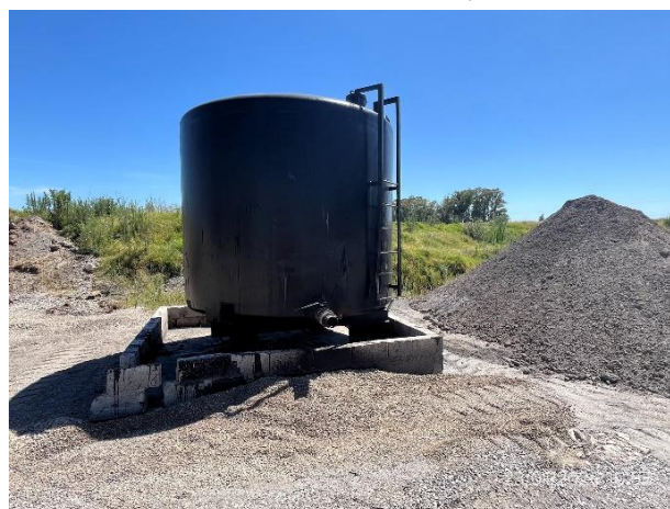
Foto 12.1-4, P07. Tanque de emulsión, envallado perimetral perforado con capacidad disminuida.
