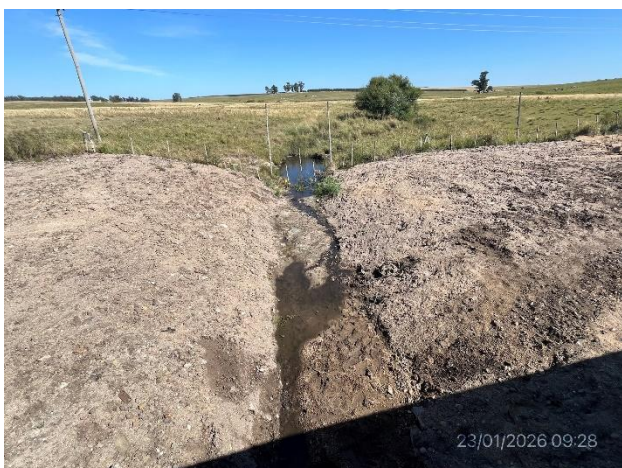
Foto 12.2-17, P03. El curso aguas abajo parece haber sido invadido por la plataforma de trabajo. Está pendiente la ejecución de la batimetría ex – post.
