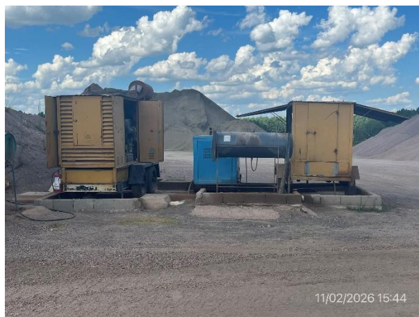
Foto 12.1-10, P03. Obrador, generadores eléctricos dotados de envallados perimetrales.
