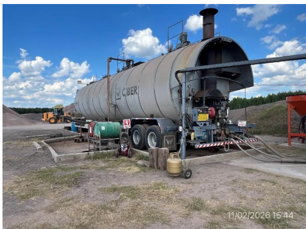
Foto 12.1-3, P03. Planta asfáltica, cisterna de emulsión con envallado perimetral impermeable.
