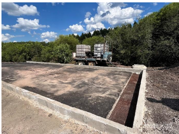
Foto 12.1-9, P03. Obrador, lavadero de camiones con superficie impermeable y trampa de retención de aguas oleosas.
