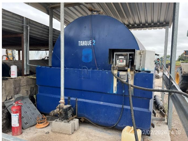
Foto 12.2-7, P03. Obrador, tanque y dispensador de combustible ubicado en recinto estanco.
