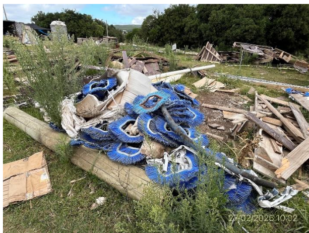
Foto 12.3-5, P03. Obrador, hay residuos mezclados con materiales de reúso.
