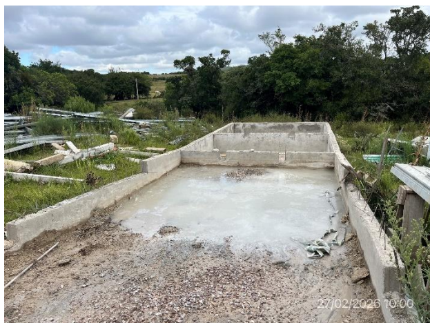
Foto 12.3-7, P03. Obrador, pileta de decantación de aguas de lavado de camiones mixer.
