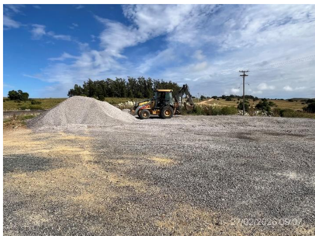
Foto 12.3-19, P08. El campamento provisorio no cuenta con infraestructura para el acopio temporal de residuos.
