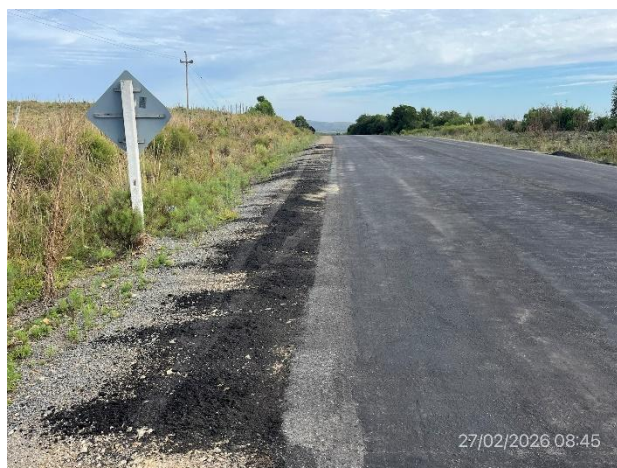
Foto 12.1-4, Ruta 12. Hay derrames repetidos y dispersos de Cape Seal hacia la faja pública de la senda a (-)
