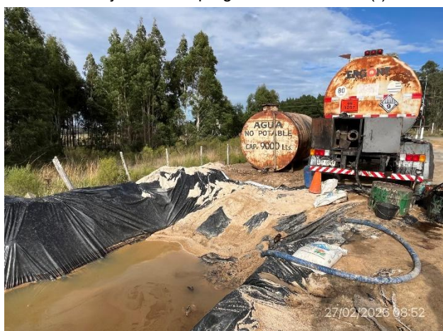
Foto 12.3-17, P07. Se construyó una contención estanca que no cumple con su finalidad, por quedar alejada de la cisterna de emulsión.
