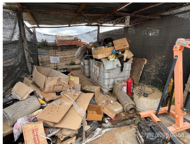
Foto 12.3-4, P03. Obrador, el sector de acopio de residuos se encuentra colmado.
