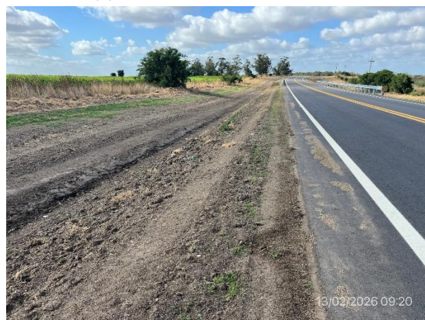
Foto 12.1-6, Ruta 76. Cunetas con buen drenaje y tapiz vegetal en crecimiento.
