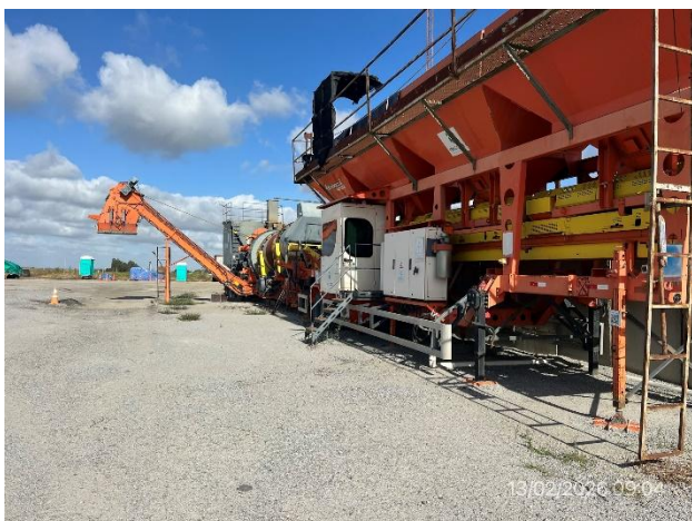
Foto 12.2-3, P03. Planta asfáltica sin actividad, buenas condiciones de orden y limpieza, no hay derrames a la vista.
