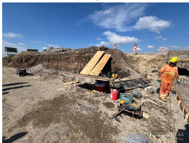
Foto 12.2-10, P06. Frente de obras, faltan los elementos para el acopio de residuos segregados en origen.
