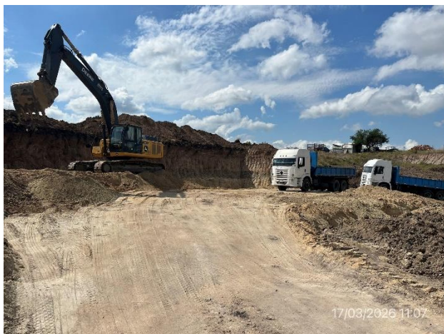
Foto 12.1-11, P04. Frente de explotación, no se dispone de infraestructura para acopio de residuos ni de elementos para gestión temprana de contingencias ambientales.
