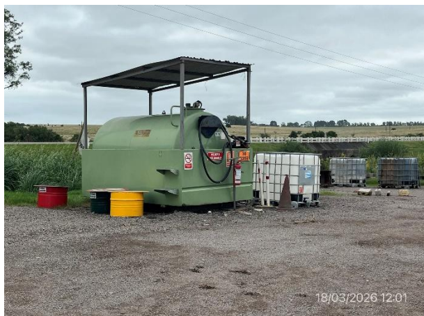
Foto 12.1-9, P06. Obrador, tanque dispensador de combustible envallado y techado.
