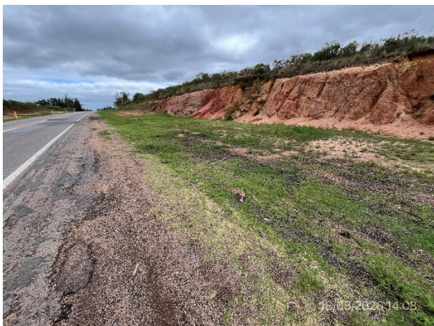
Foto 12.2-5, P07. Ruta 17 progresiva 296K300. Hay restos de RAP en la faja pública.
