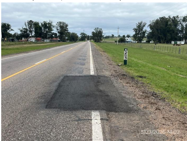
Foto 12.2-3, Ruta 17. Bacheo ejecutado en calzada y banquina de senda a (+). Está pendiente la restitución de la señalización horizontal.
