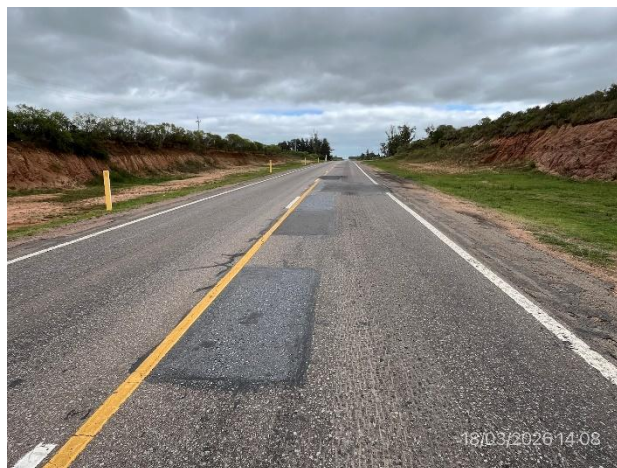
Foto 12.2-6, P07. Hay importantes erosiones en los taludes a (+) y a (-), no imputables al contrato auditado.
