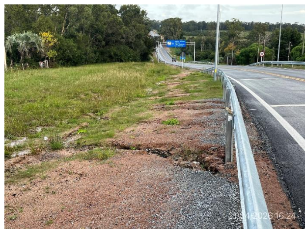
Foto 12.1-6. Ruta 16, erosiones puntuales en los taludes de la faja pública de la senda a (+).
