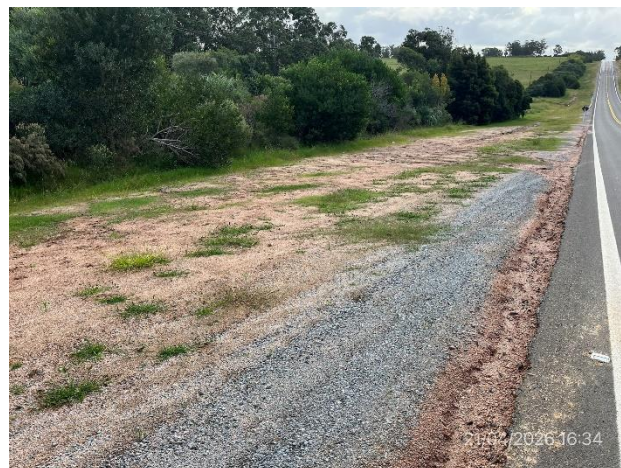
Foto 12.1-8, Ruta 16, erosión lineal en el hombro del talud de la faja pública de la senda a (-).
