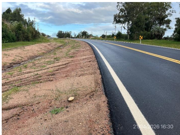
Foto 12.1-7, Ruta 16, erosiones puntuales en los taludes de la faja pública de la senda a (-).
