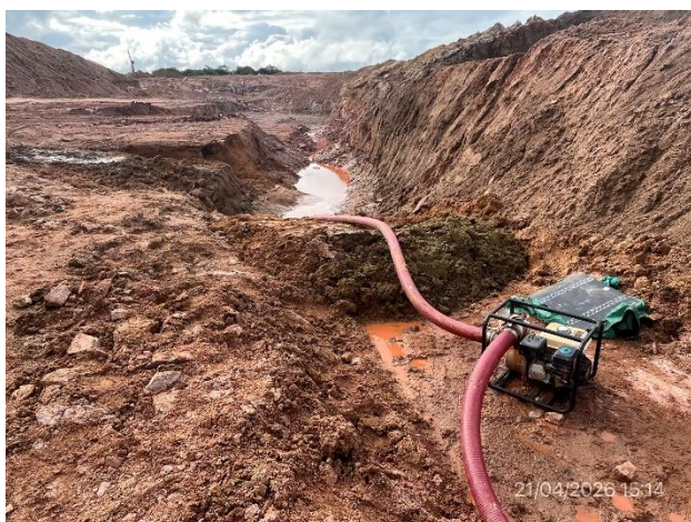
Foto 12.2-15, P05. Se desagota el fondo de la excavación por medio de una motobomba apoyada sobre suelo desnudo, sin elementos de contención de derrames.
