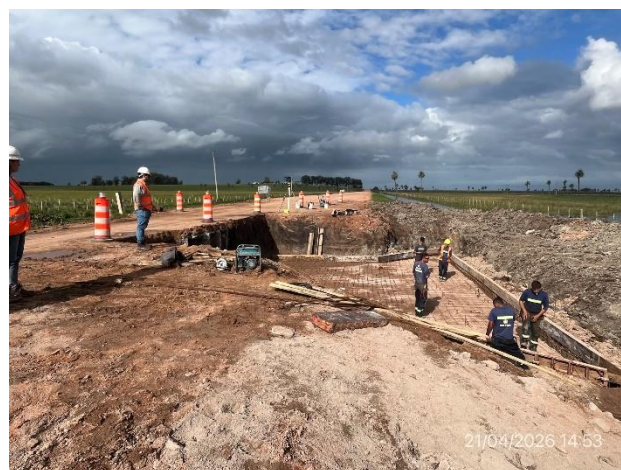
Foto 12.1-10, P07. Faltan servicios de bienestar y EPP para los operarios, el kit antiderrames, infraestructura para acopio de residuos, bandejas para generadores.
