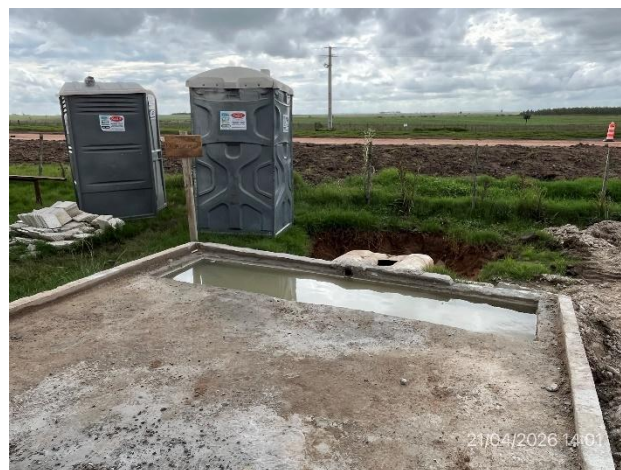
Foto 12.2-12, P04. Pileta de lavado de tolva méixer con pendiente hacia sistema de decantación.
