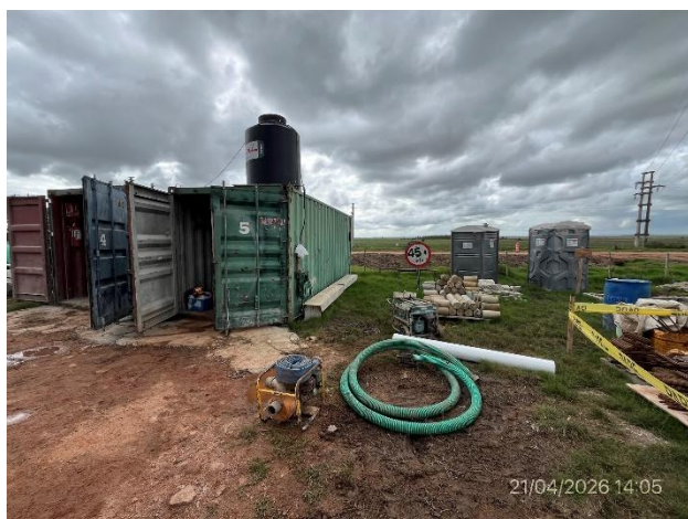
Foto 12.2-9, P04. No está presente la infraestructura para el acopio segregado de residuos en origen.
