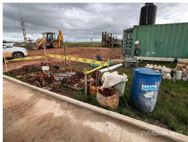
Foto 12.2-10, P04. Hay un tanque de gasoil apoyado sobre suelo desnudo, sin elemento de contención de eventuales derrames.
