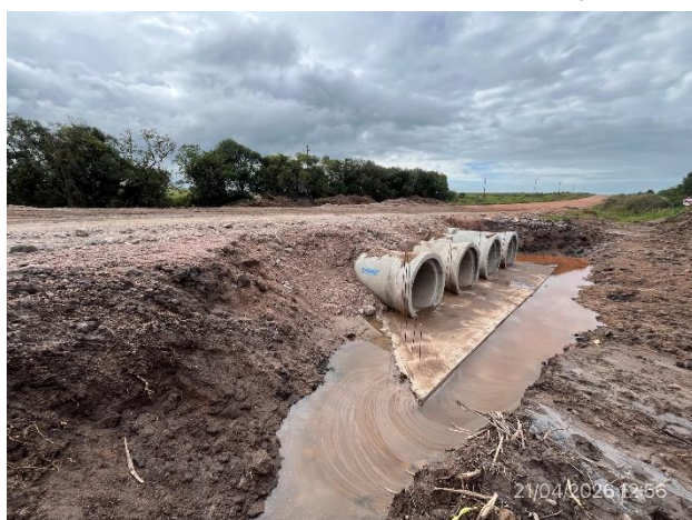
Foto 12.1-5. Ruta 14, fondo de alcantarilla H en ejecución. Hay derrames de acelerante en lecho de alcantarilla.
