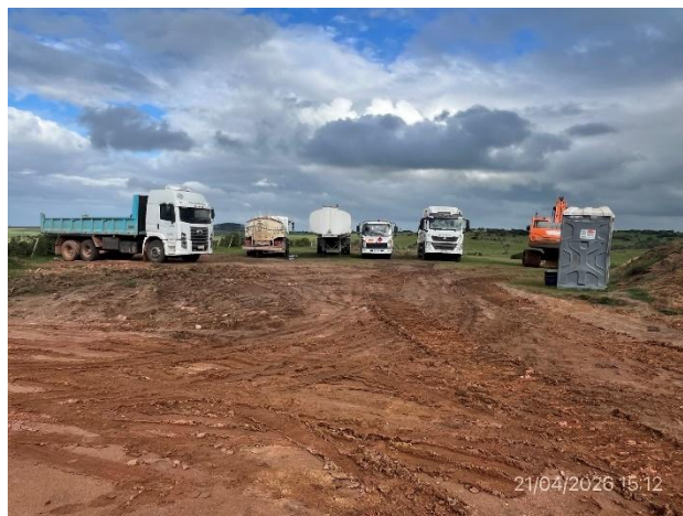
Foto 12.2-14, P05. No están presentes los servicios de bienestar para los operarios.
