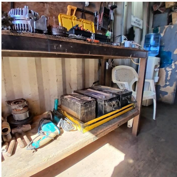
Foto 12.3-1, P03. Obrador Traxpalco SA, se colocaron bandejas bajo baterías en el pañol.
