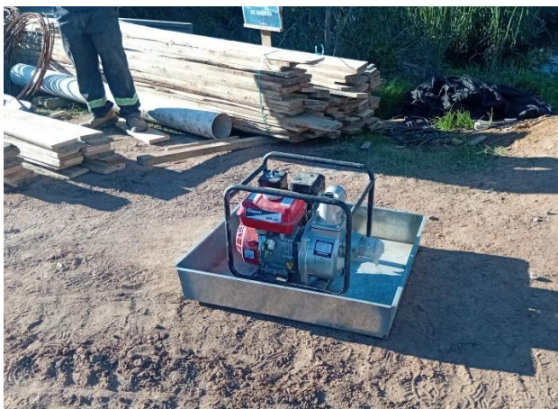
Foto 12.5-1, P01. Puente sobre A° Tranqueras, se agregó bandeja bajo generador eléctrico.
