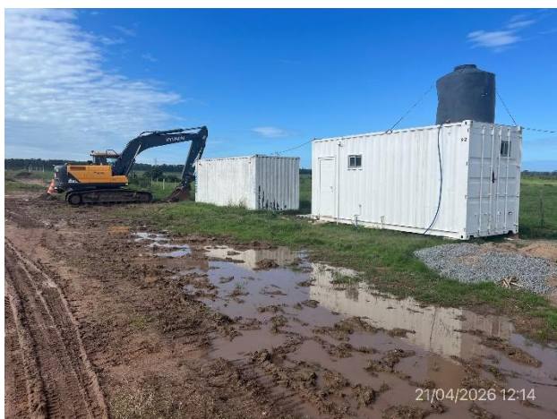
Foto 12.1-5, P03. Obrador provisorio instalado fuera de la zona de veda. Falta infraestructura para acopio de residuos y kit antiderrames.
