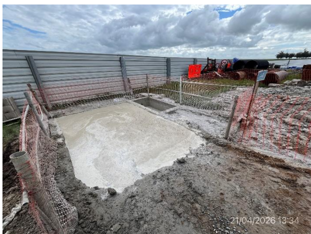
Foto 12.4-11, P04. Planta de hormigón, la pileta de descarga de aguas con hormigón está colmada y no desagua.
