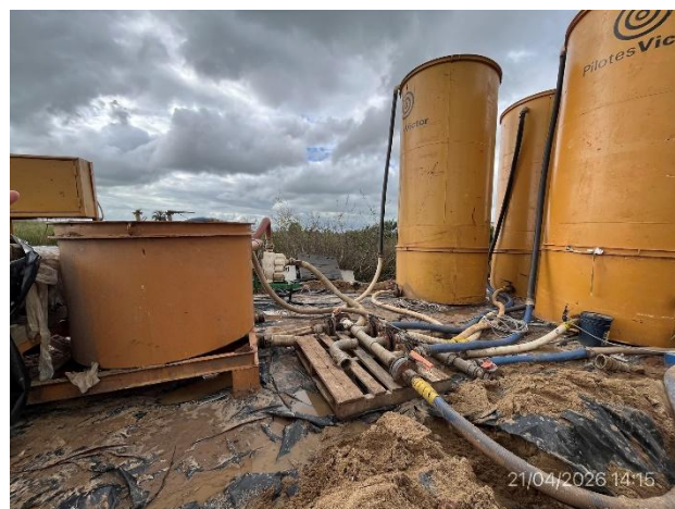
Foto 12.3-6, P01. Sistema de almacenaje y recirculación de lodos bentoníticos en operación.
