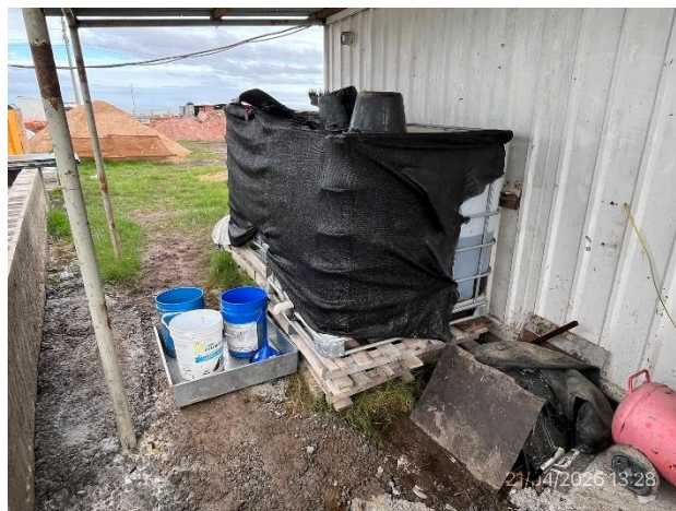
Foto 12.4-8, P04. Planta de hormigón. Los productos químicos no tienen un envallado perimetral.
