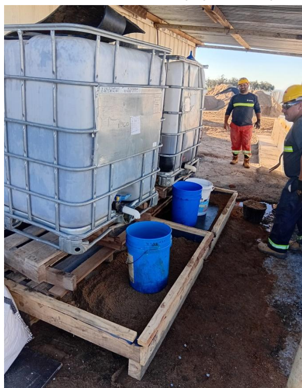
Foto 12.5-7, P04. Se generó un envallado perimetral estanco, pero no es capaz de contener el 110% del volumen almacenado
