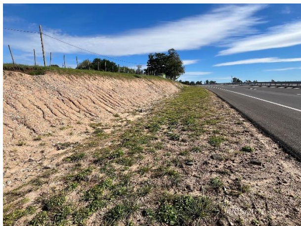
Foto 12.1-9, Ruta 9, hay erosiones atribuibles al escurrimiento pluvial sobre suelo desnudo en los taludes de la faja pública, senda a (+).
