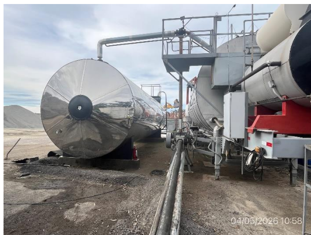
Foto 12.2-2, P05. Planta asfáltica, cisterna de emulsión con envallado perimetral correcto.
