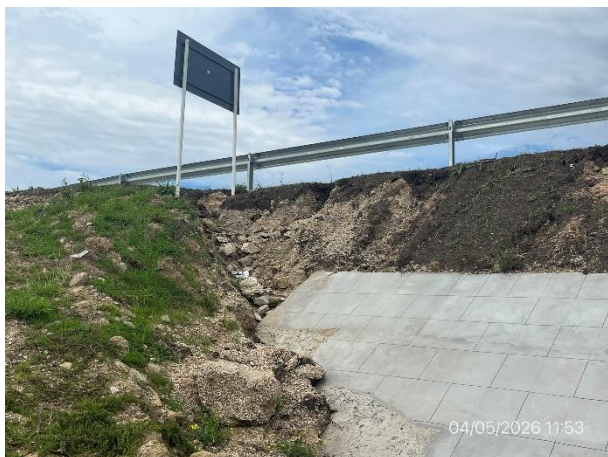
Foto 12.2-5, P02. Zona de talud en ¼ de cono este con erosiones atribuibles a escorrenría pluvial.
