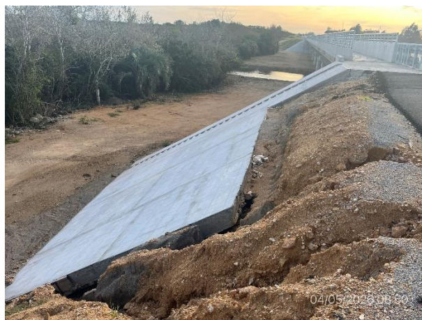
Foto 12.5-6, P05. Zona de talud en ¼ de cono oeste con erosiones atribuibles a escorrentía pluvial.
