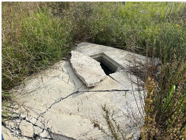
Foto 12.6-5, P06. Está pendiente de ser retirado y rellenado el depósito de aguas servidas.
