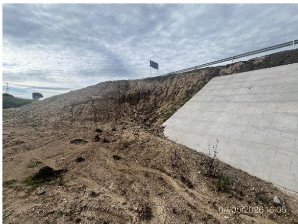
Foto 12.3-5, P03. Zona de talud en ¼ de cono este con erosiones atribuibles a escorrenfía pluvial.
