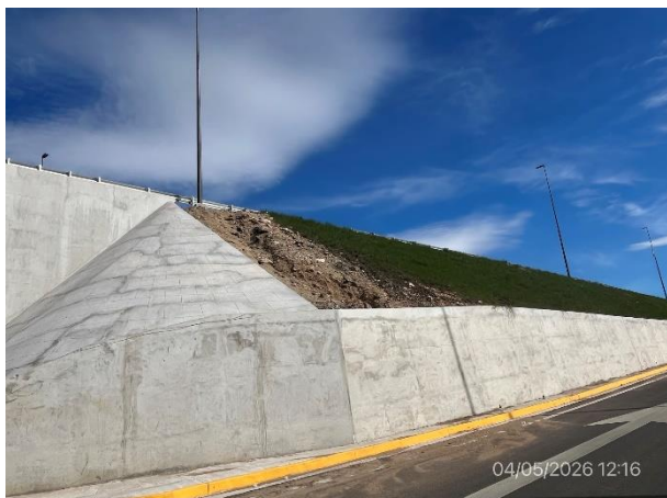
Foto 12.1-5, P01. Revestimientos de ¼ de cono con erosiones atribuibles a escorrentía pluvial, senda (+)
