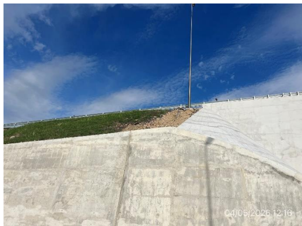
Foto 12.1-6, P01. P01. Revestimientos de ¼ de cono con erosiones atribuibles a escorrentía pluvial, senda (-).
