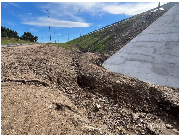
Foto 12.1-4, P01. Cunetas con erosiones atribuibles a escorrentía pluvial.
