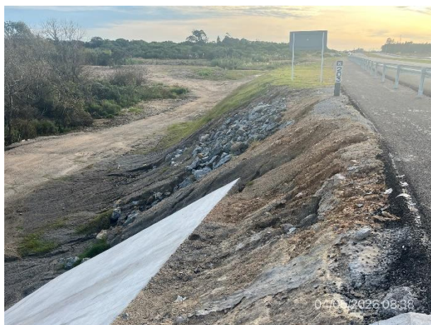
Foto 12.5-5, P05. Zona de talud en ¼ de cono este con erosiones atribuibles a escorrentía pluvial.
