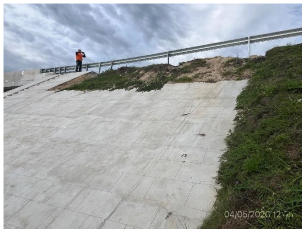
Foto 12.2-6, P02. Zona de talud en ¼ de cono oeste con erosiones atribuibles a escorrenría pluvial.
