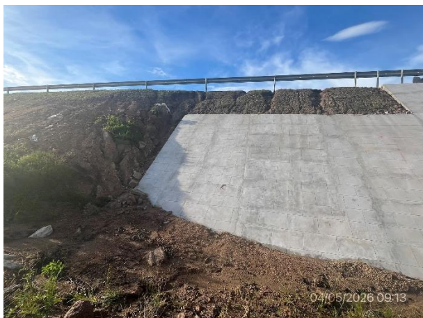
Foto 12.4-5, P04. Zona de talud en ¼ de cono este con erosiones atribuibles a escorrentía pluvial.
