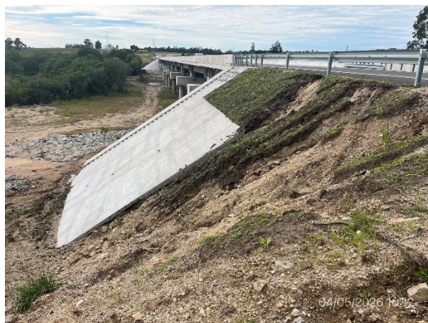
Foto 12.3-6, P03. Zona de talud en ¼ de cono oeste con erosiones atribuibles a escorrenfía pluvial.
