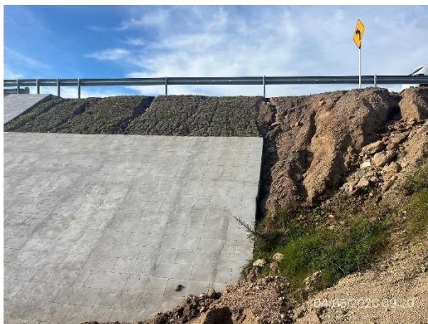
Foto 12.4-6, P04. Zona de talud en ¼ de cono oeste con erosiones atribuibles a escorrentía pluvial.
