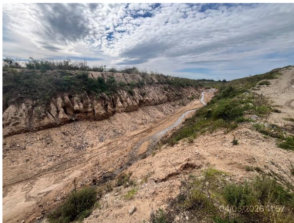
Foto 12.2-4, P02. Hay importantes erosiones imputables a la obra vial de la senda a (-), atribuibles al escurrimiento pluvial sobre suelo sin cobertura vegetal.
