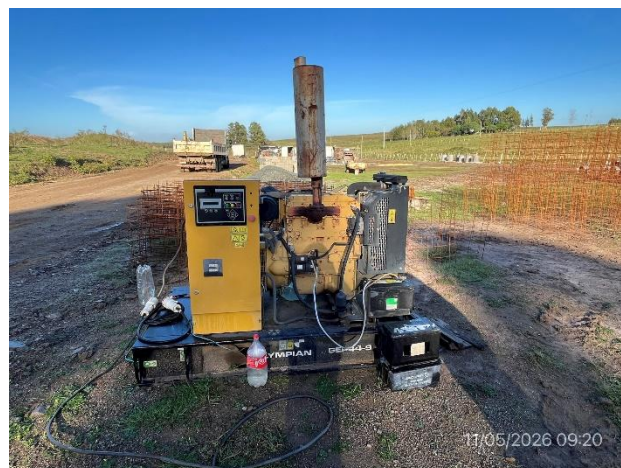
Foto 12.2-8, P03. Obrador, generador eléctrico. No cuenta con bandeja estanca para contención de eventuales derrames.
