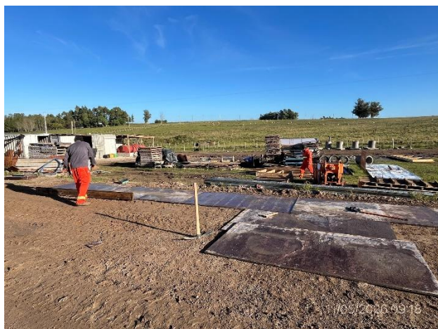
Foto 12.2-5, P03. Obrador, se está montando explanada para prefabricación. No hay infraestructura suficiente para el acopio de residuos.
