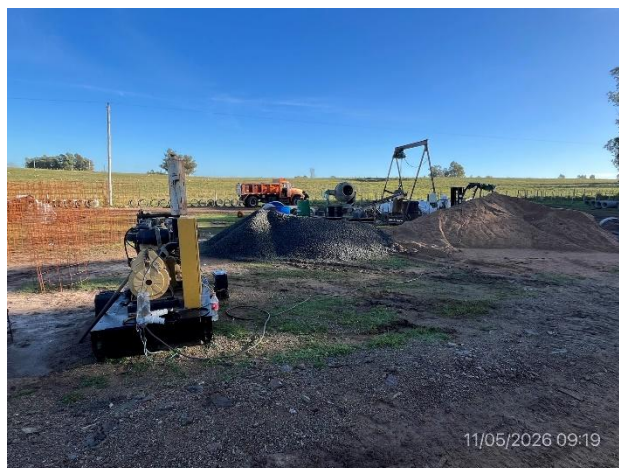
Foto 12.2-6, P03. Obrador, planta de fabricación de caños de hormigón. No hay infraestructura suficiente para el acopio de residuos.
