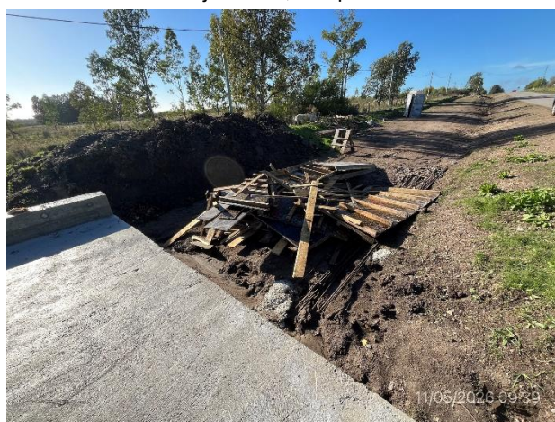
Foto 12.1-10, P05. Hay insumos de obra en zona inundable.
