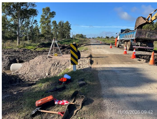
Foto 12.1-12, P06. No se instaló un campamento provisorio ni los servicios de bienestar para los operarios.
