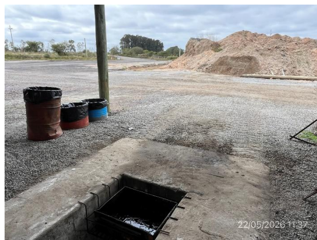
Foto 12.2-4, P05. Obrador, taller mecánico en buenas condiciones de orden y limpieza, dotado de elementos para acopio de residuos y fosa para cambio de aceite.
