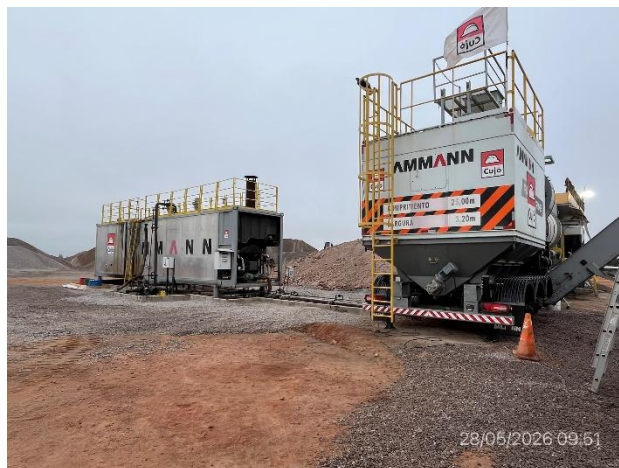
Foto 12.1-10, P03. Planta asfáltica, dispone de envallado perimetral pero no alcanza a cubrir el 110% del volumen de hidrocarburos alojados.
