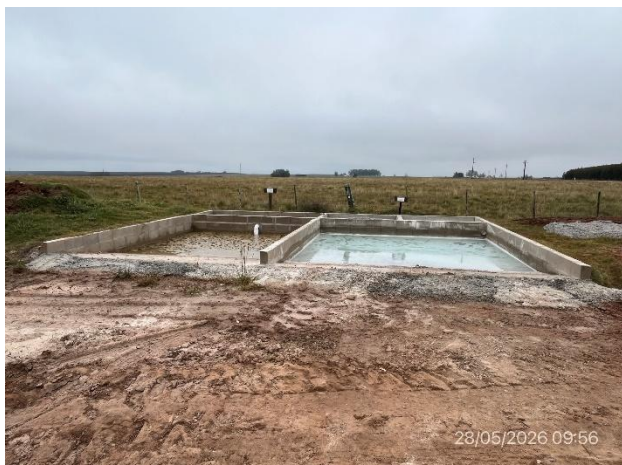
Foto 12.1-7, P03. Planta de hormigón. Pileta de lavado de camiones mixer con decantación y retención de sólidos.
