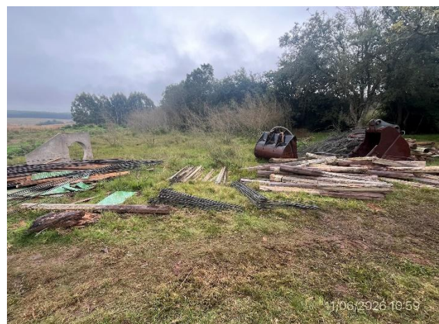
Foto 12.1-6, P03. Obrador, acopio de insumos próximos a vegetación, sin indicación de zonificación.
