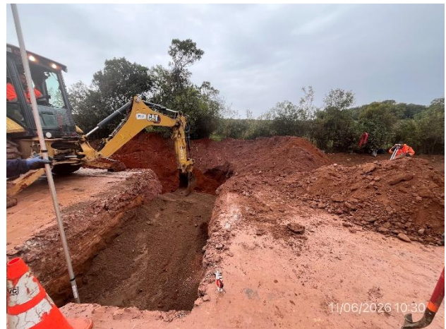
Foto 12.2-8, P06. No se instaló campamento provisorio, faltan los servicios de bienestar para los operarios y la infraestructura para el acopio de residuos.
