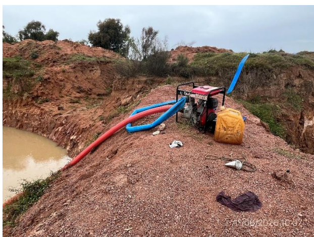
Foto 12.1-11, P04. Cantera de tosca, motobomba de drenaje. Faltan bandejas para contención de derrames y un kit para gestión eventuales de contingencias ambientales
