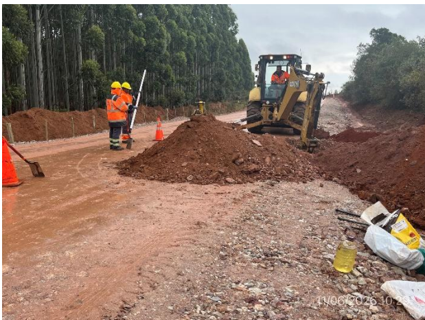
Foto 12.2-9, P06. No se dispone de bandejas para alojar bidones con combustible ni elementos para la atención temprana de contingencias ambientales.
