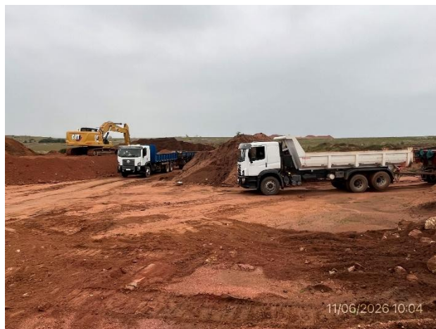
Foto 12.1-10, P04. Cantera de tosca. Faltan servicios de bienestar para operarios e infraestructura para acopio de residuos segregados en origen.
