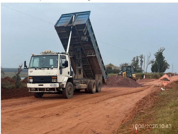
Foto 12.2-11, P07. Frente de obras, faltan los servicios de bienestar para los operarios y la infraestructura para el acopio segregado de residuos.
