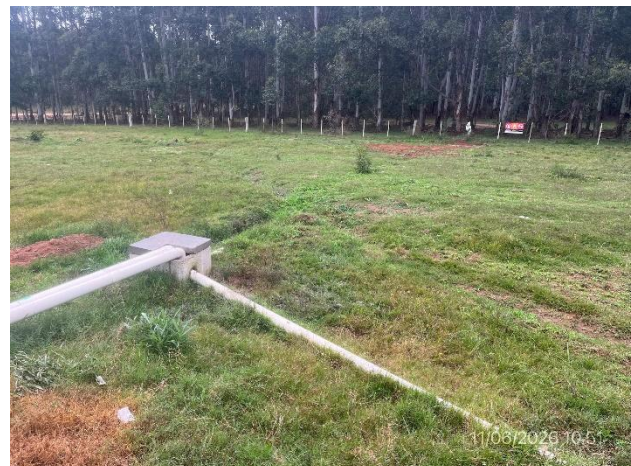
Foto 12.1-4, P03. Obrador, sistema de conducción de aguas servidas hacia depósito impermeable.
