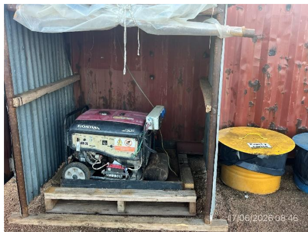
Foto 12.1-10. P06, Generador eléctrico está ubicado en un recinto techado y sobre una bandeja estanca.
