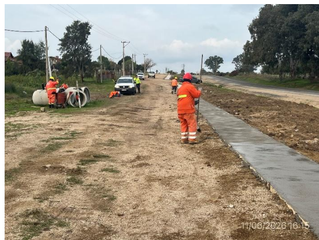
Foto 12.1-12, P07. Frente de obra, no se dispone de servicios de bienestar para los operarios ni de infraestructura para acopio de residuos.
