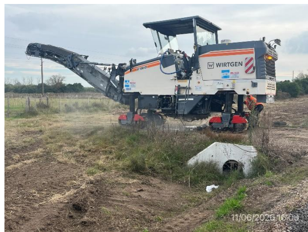
Foto 12.1-10, P08. Ruta 12 progresiva 81K700. Se realiza el lavado de la fresadora en faja pública, sin controlar parámetros de vertido de efluentes.
