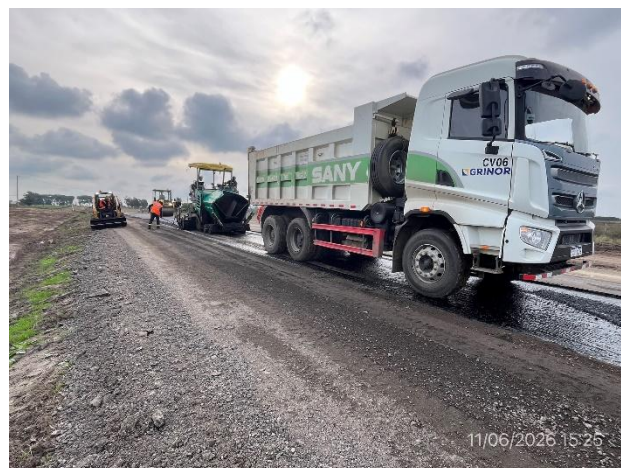
Foto 12.1-8, P06. El frente de trabajo no cuenta con baños ni infraestructura para acopio de residuos.
