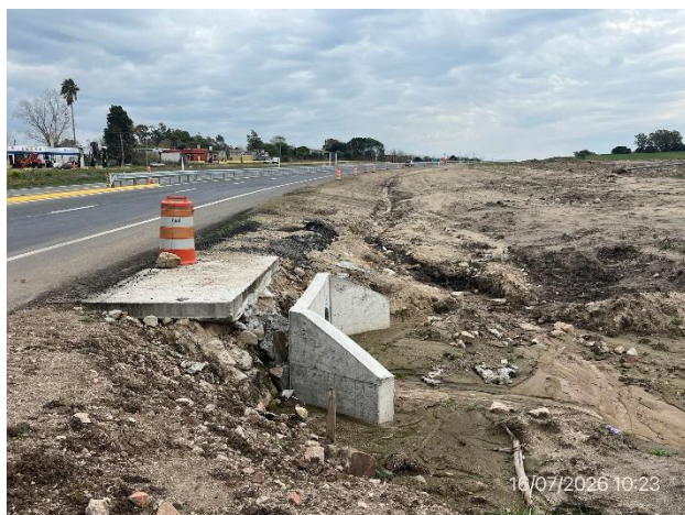
Foto 12.1-3, P01. Rotonda en construcción. Desagüe mal conformado, no garantiza escurrimiento en fase de obra.
