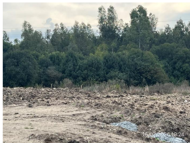
Foto 12.1-4, P01. Hay sobrantes de excavaciones en faja pública, pendientes de disposición final.
