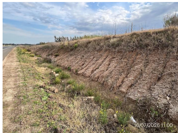
Foto 12.1-14, Bypass Ruta 1. Tramo con erosiones en faja pública, atribuibles a escorrentía pluvial.
