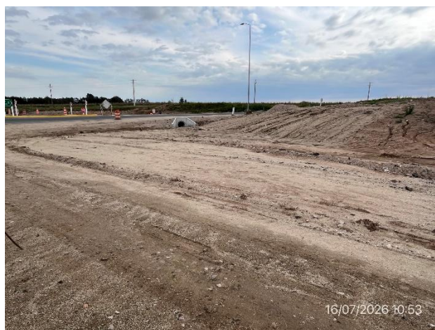
Foto 12.1-10, P07. Están pendientes de terminar las obras de desagües y la cobertura vegetal de los taludes, que presentan señales de erosión.
