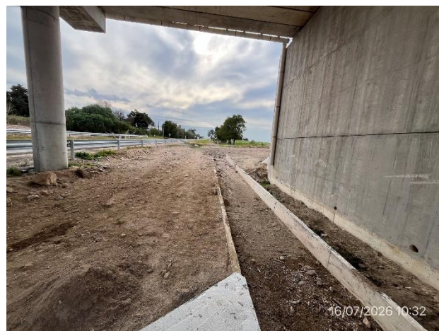
Foto 12.1-6, P06. Puente sin actividad. Están pendientes de terminar las obras de desagües y veredas perimetrales.
