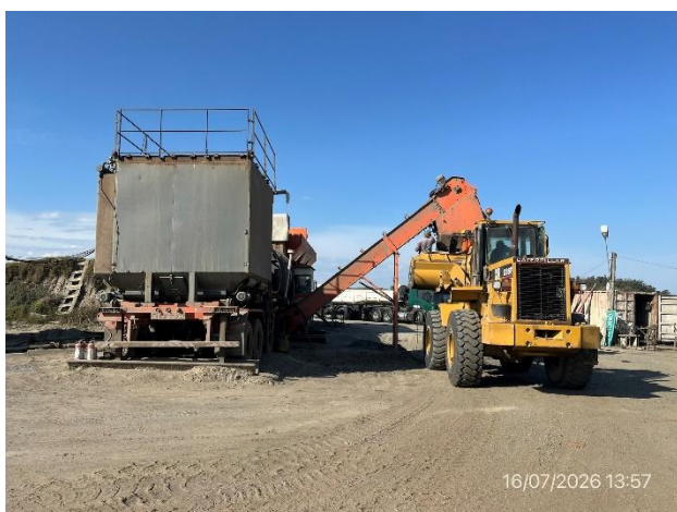
Foto 12.2-9, P03. Planta asfáltica. Zona de maniobras con buenas condiciones de orden y limpieza.
