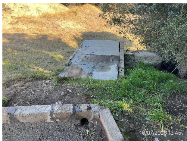
Foto 12.2-4, P03. Obrador. Pileta de decantación de aguas de lavado contaminadas con hidrocarburos.
